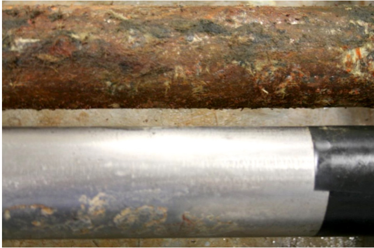
Superficie de tubería tras 210 días de pruebas de corrosión. VpCI®-658 fue aplicada hasta el fondo de la tubería.
